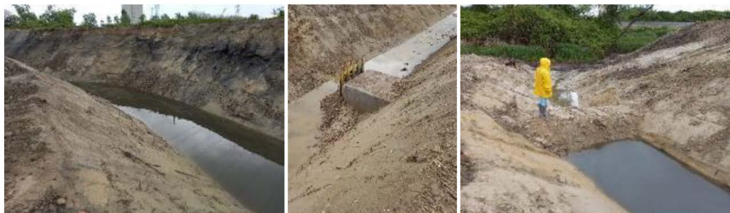
Figura 5: affioramenti nerastri in scarpa e particolari delle arginature realizzate e delle acque in cunetta
